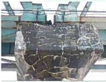
橋脚に発生したASR
